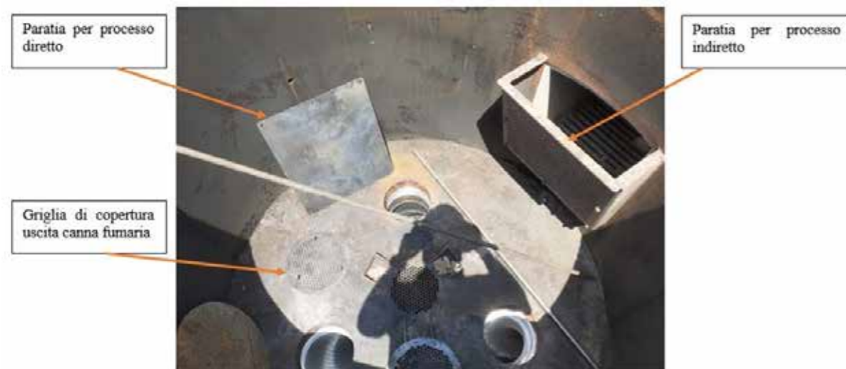
Fig. 54 - Interno della carbonaia, si possono osservare i tre fori di comunicazione con le tubazioni di raccordo con la canna fumaria che devono essere coperte con le griglie adottando il metodo di carbonizzazione diretto.
